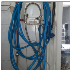
Lot 30 : CENTRALE DE NETTOYAGE
